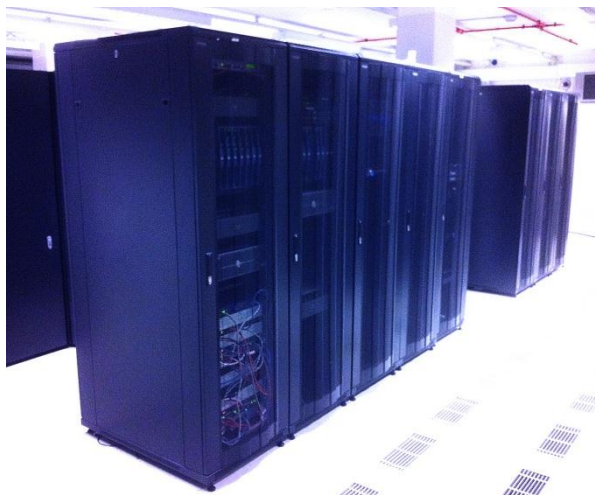
VMI Data Center Kista
